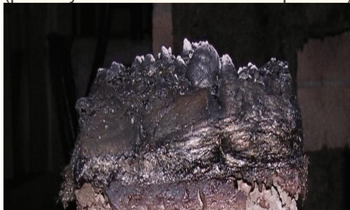
Рис.1. Вспененный слой огнезащитного покрытия «Нертекс»
